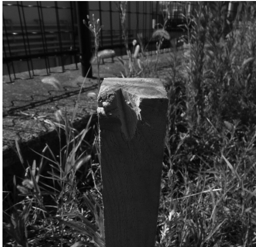
写真10 (検証2 : 杭が割れた状態)
