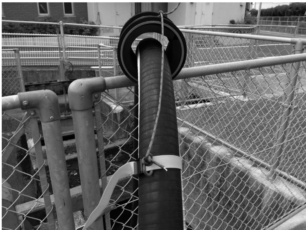
写真 9 吸管備え付け型枕木内部と吸管の状況
