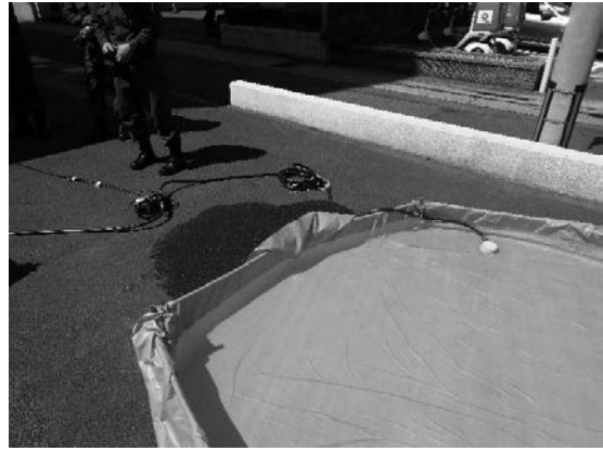
写真 2 0 . 排水ポンプ設定状況
