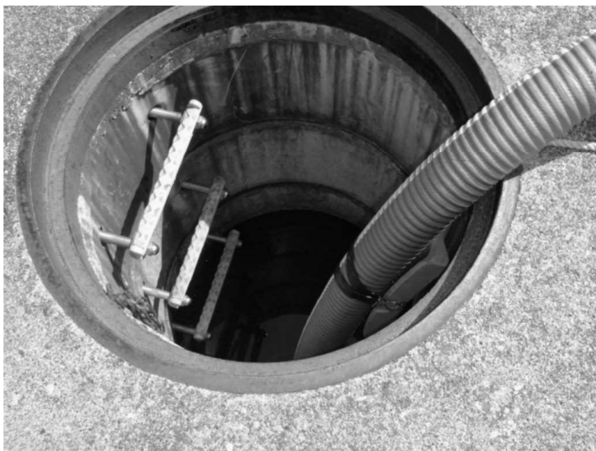
従来品揚水後の状況（マンホール内にずれ落ち）
