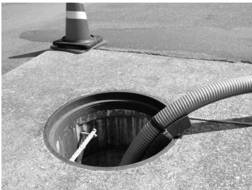
改良品揚水前の状況
