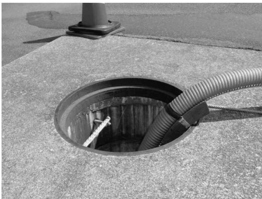
改良品揚水後の状況（マンホール縁に掛かる）
