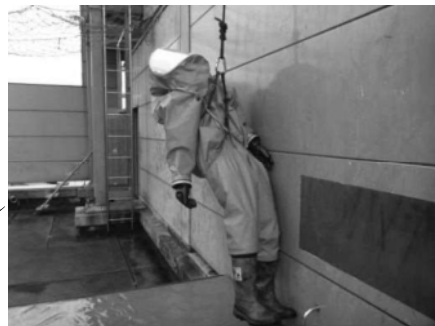
転落危険なし
