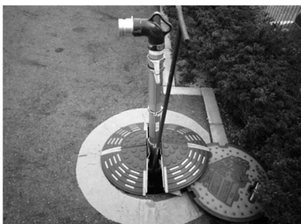
写真 1 2 「転落防止：消火栓の蓋」
