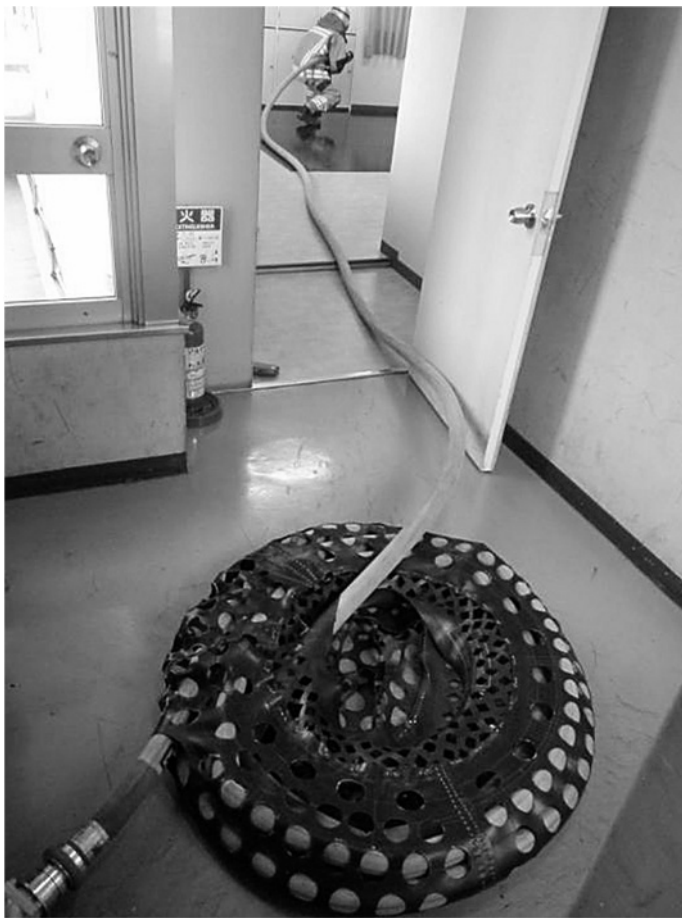
写真8 放水態勢（ホースを引き出した状態）
