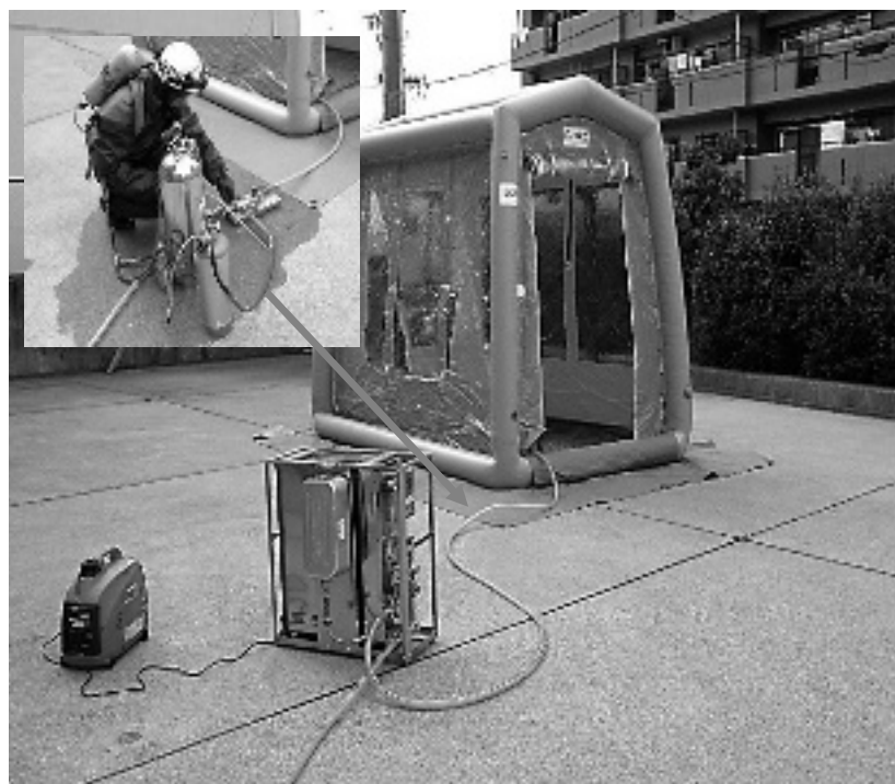
写真No. 1 開発したハイブリッドラインの使用法(接続)
