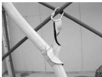
28 ホースの脱落防止
