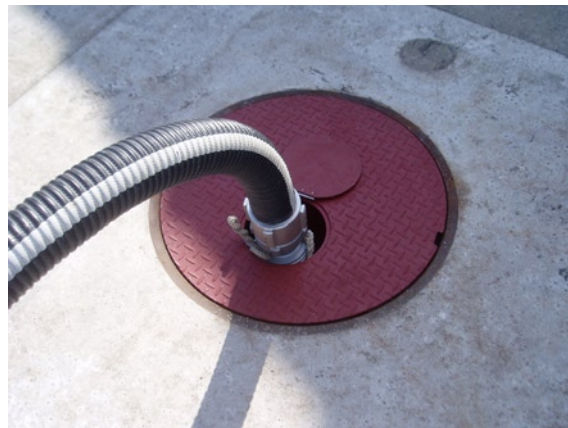
写真8 揚水準備が整った状態。開口部が無いいため安全である。
