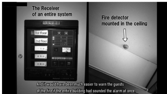
写真 21 自動火災報知設備の見方
